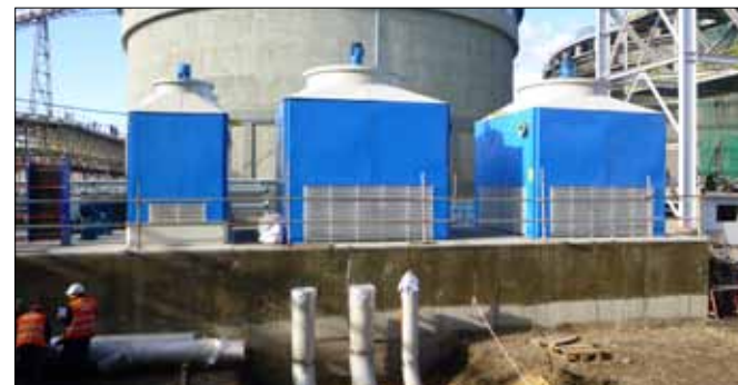
Instalace aparátů UGL – chladicí mikrověže.
