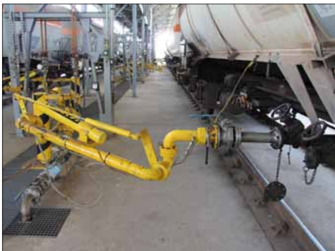
Napojení cisteren na stáčecí ramena
