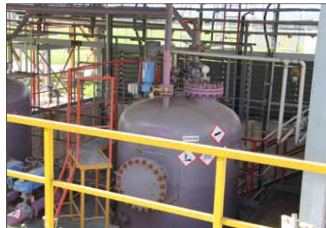
Předloňové nádrže na stáčení čpavku
