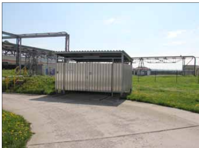
Přístřešek pro dieselagregát, záložní zdroj elektrického proudu
