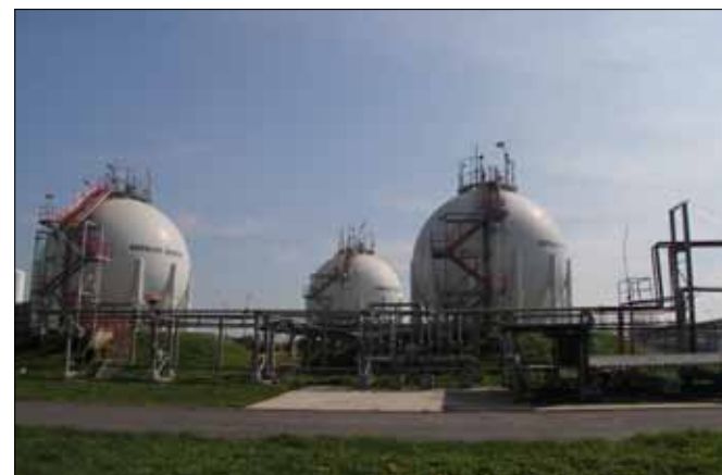
Zásobníky kapalného čpavku s rozdělovačem kapalného čpavku a sběračem plyného čpavku
