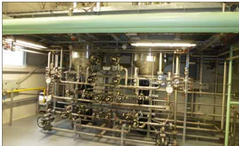
Jednotka filtrace bělicí hlíny.
