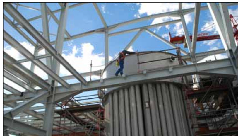
Instalace aparátů UGL - WESP.
