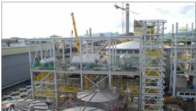
Zásobníkové pole a jednotka DA.
