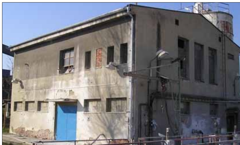
Výrobní vápenného mléka - stav před opravou.
