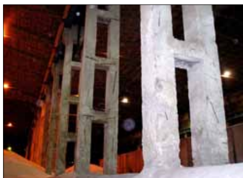
Středové pilíře skladovací haly před opravou.
