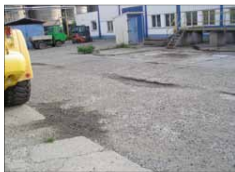
Betonové plochy u Autodopravy - stav před opravou.
