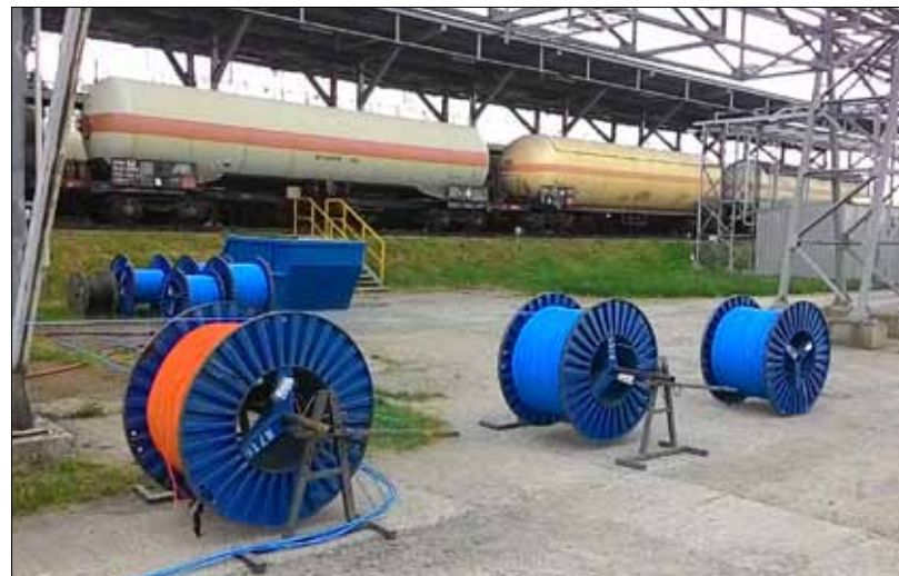
Připrava pro cca 40 km kabeláží - PENTO.
