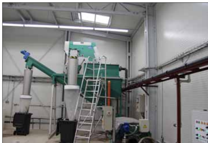
Integrované hrubé mechanické předčištění.
