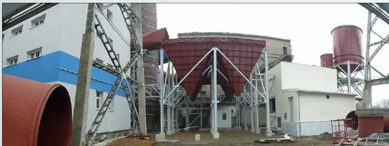
Výsypky budoucího filtru spalin.
