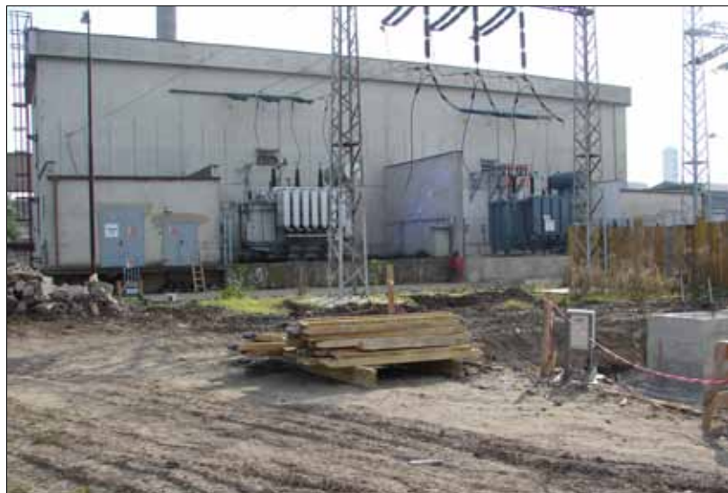
Trafostanice 110 kV – původní (vlevo) a nový transformátor 110/6,3 kV.
