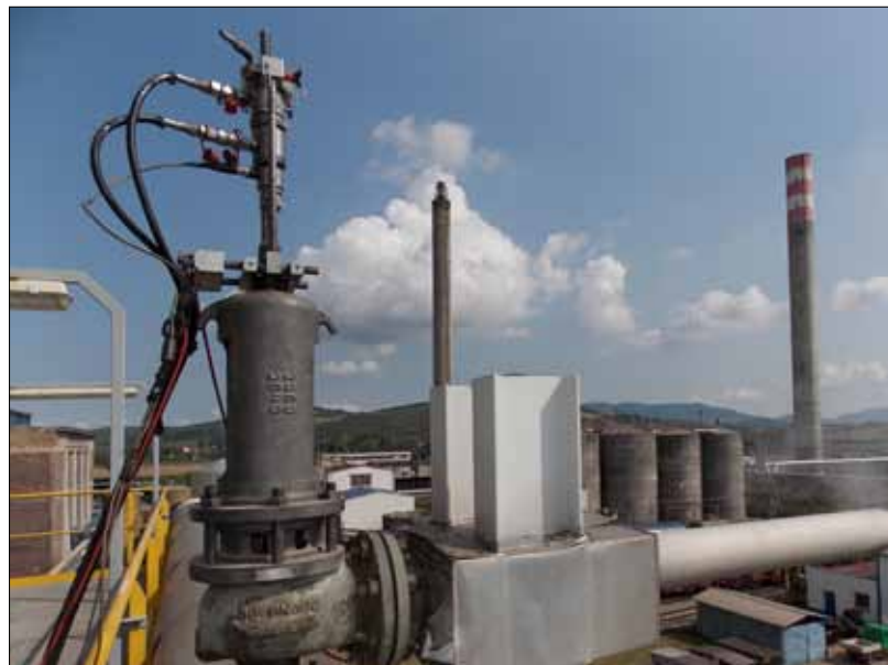
Zkoušený pojistný ventil v okamžiku odpuštění média.
