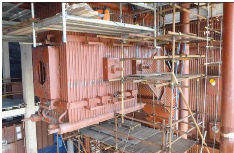
Obr. 1. - Přesyp z cyklónu do spalovací komory.
