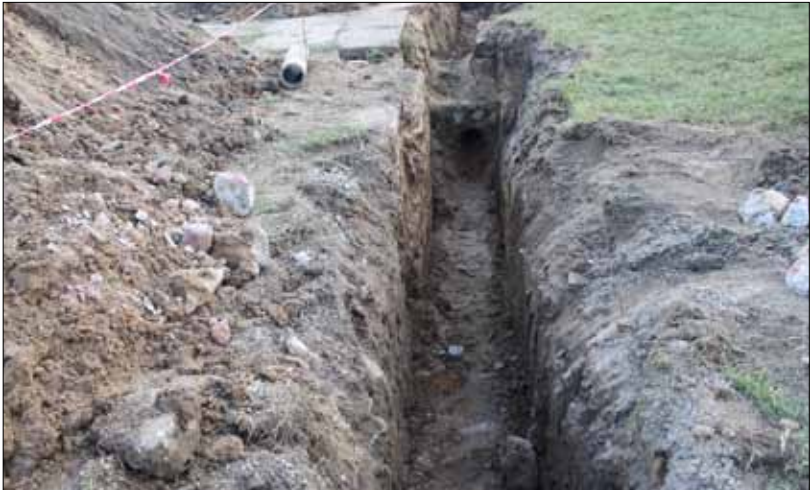
Nezajištěný výkop. Foto: Jan Rusó
