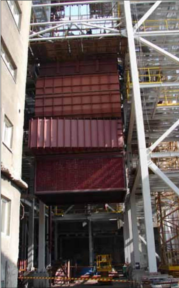
Předehřívače vzduchu a ekonomizéry.
