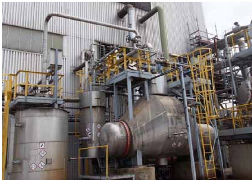
Část výrobního zařízení na LAV3.
