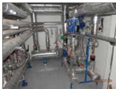
Objektová předávací stanice pro hlavní sklad.
