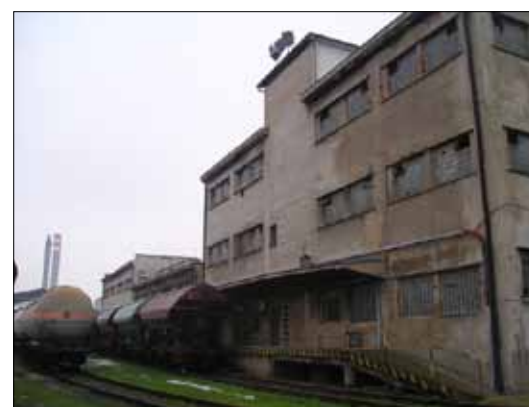
Úprava vody - před opravou.
