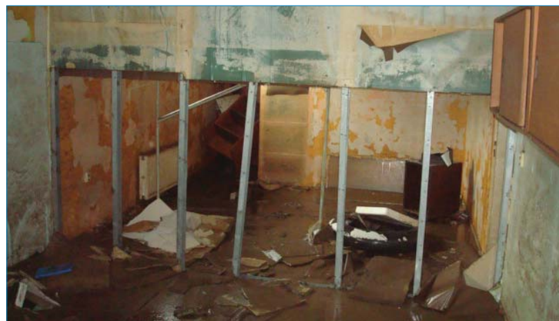
Zázemí provozní budovy po povodni.
