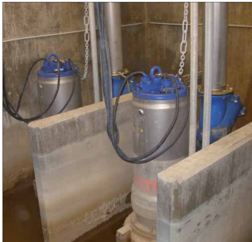
Čerpadlo na ČOV.
