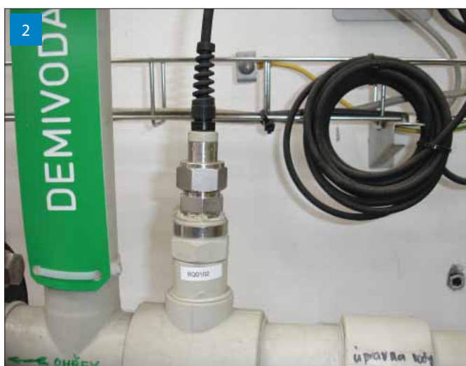
Čistotu přitékající vody do zásobníků hlídá snímač vodivosti.
