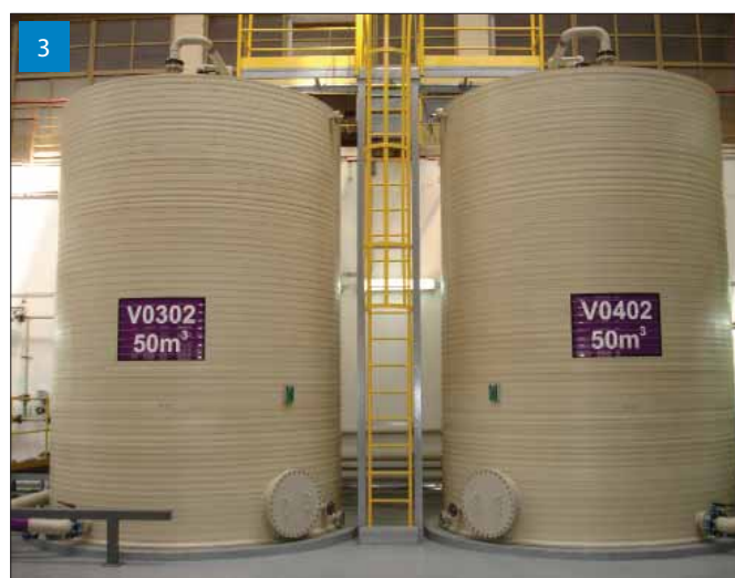
Zásobníky o objemu 50 m³ slouží pro samotný proces rozpouštění a zároveň skladování produktu.
