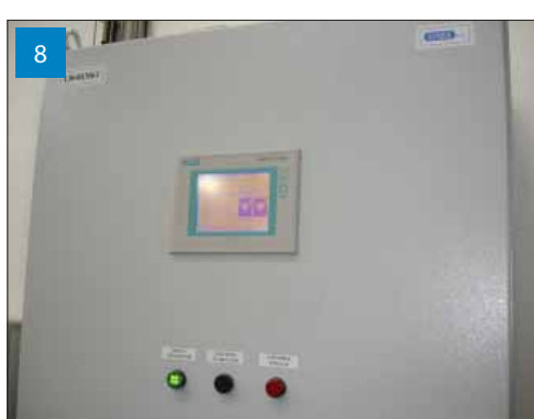
Dotykový panel s řídicím systémem Simatic, který slouží k ovládání technologie.
