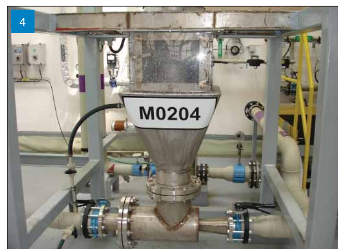
Tzv. ejektor – zařízení, jímž protéká pod tlakem demineralizovaná voda a strhává s sebou močovinu, která se volně odsypává z big bagu, visícího nad ním. Všechny big bagy jsou naplněny na konstantní hmotnost 1 tuny.
