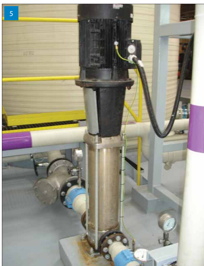
Čerpadlo, které zajišťuje potřebný tlak proudící vody.
