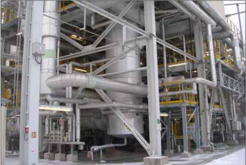
Část KD6 - pohled na spodní část kotle na odpadní teplo. Zdroj: Archiv Lovochemie
