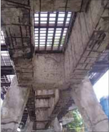
Stav poškození - detail.
