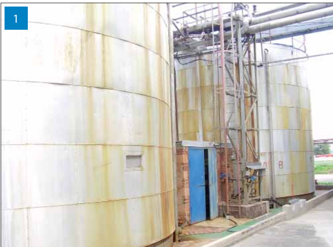
Zásobníky TDV a produktu z rozkladu vápence
