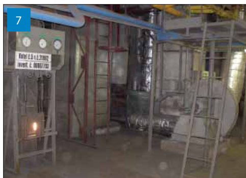
Kotel č. 5 – podlaží + 5,5 m
