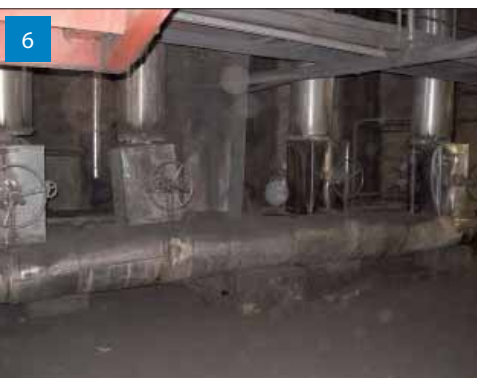
Parní řády kotlů 4 + 5
