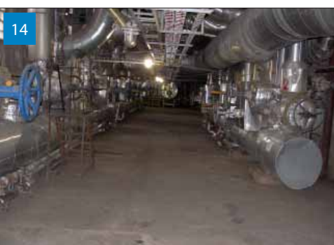
Rozvodna páry s rozvaděči páry
