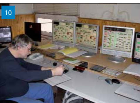
Velín kotelny a vodního hospodářství kotelny
