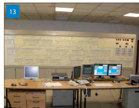
Velín závodní elektrárny
