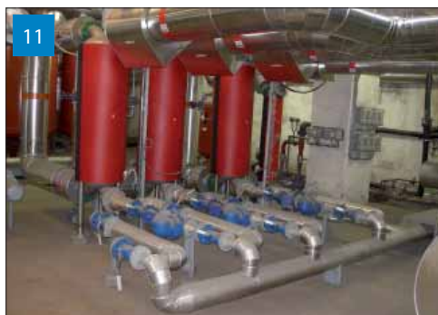
Výměňková stanice pro vytápění města
