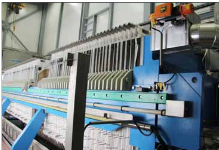
Přes filtrační kalolis se přefiltrují nečistoty, které jsou obsaženy ve vápenci (Mg, Fe, Si).
