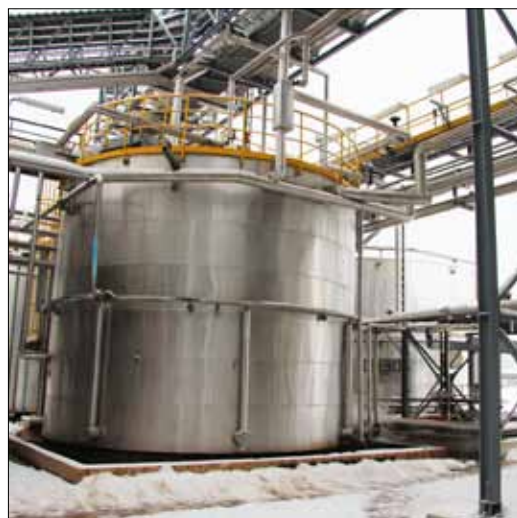
2 nádrže na nefiltrovaný roztok dusičnanu vápenatého a 1 nádrž na filtrovaný (čistý) roztok.
